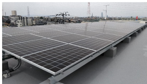
太陽光発電システム
